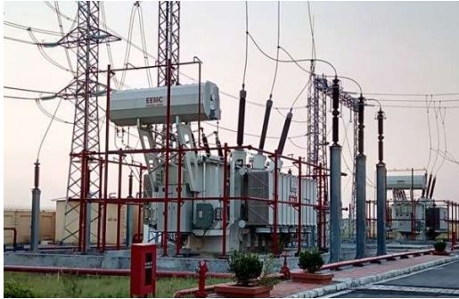
Trạm biến áp ngoài trời
