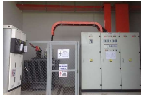
trạm biến áp trong nhà
