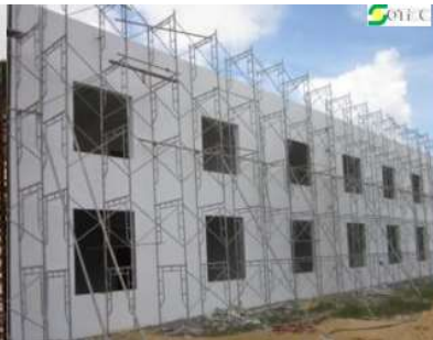
Giàn giáo gần mương rạch phải được gia cố chống sạt
